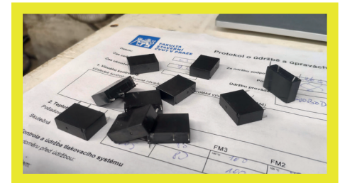
Relé řídicího systému (po servisu)
