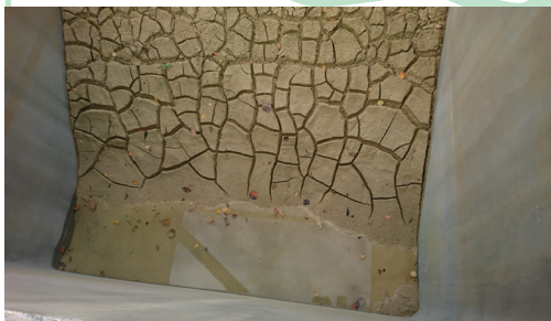
Bentonitová těsnící vrstva na povrchu hráze
