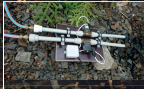
Elektromagnetické ventily pro čerpání průsakové vody
