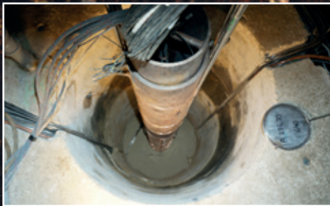
Pohled do úložné studny s topidlem
