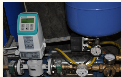
Část tlakovacího zařízení
