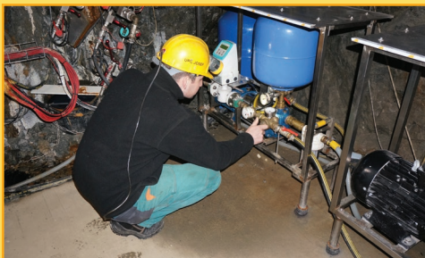
Kontrola čerpadla v technologické rozrážce
