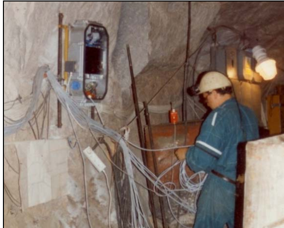
Obr. 4.13 Připojení měřicích svorníků na datalogger AD-SYS
